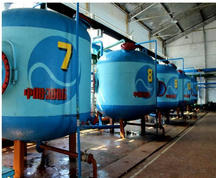
Рисунок 1.3 – Вид фильтровального зала №3
