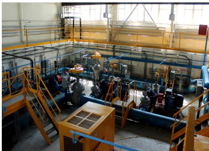
Рисунок 1.12 – Общий вид насосной станции №2
